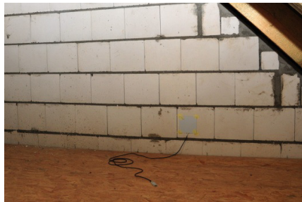
Fot.1. Niedocieplona ściana szczytowa poddasza
